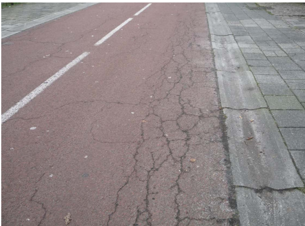
Asfaltverhardingen: Kwaliteitsklasse onvoldoende
